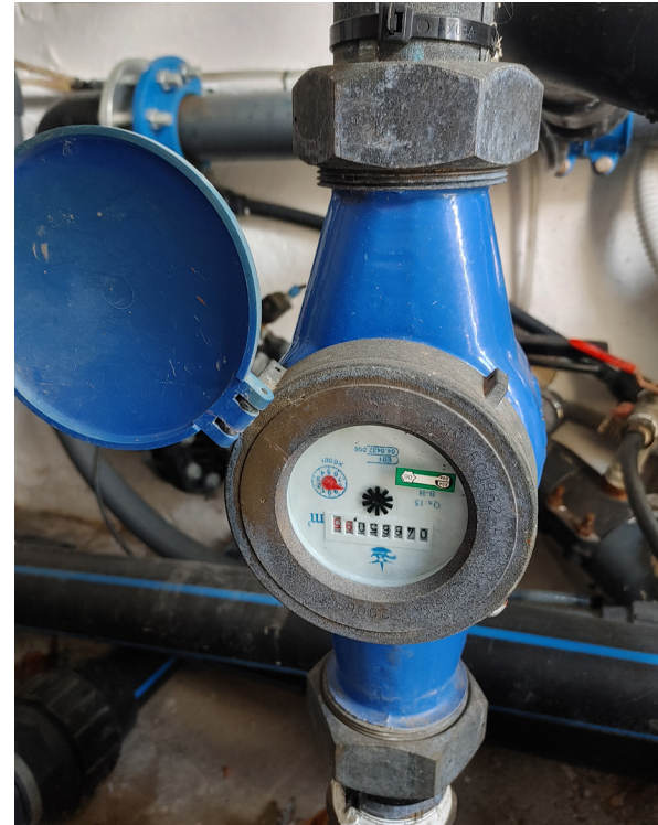
Esempio di contatore dell'acqua
